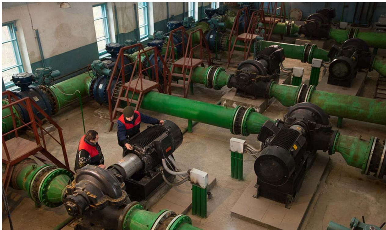
Фото: Механики предприятия «Оскемен Водоканал» в машинном зале
