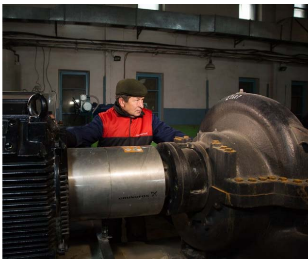
Фото: Механик предприятия «Оскемен Водоканал» осматривает оборудование GRUNDFOS
