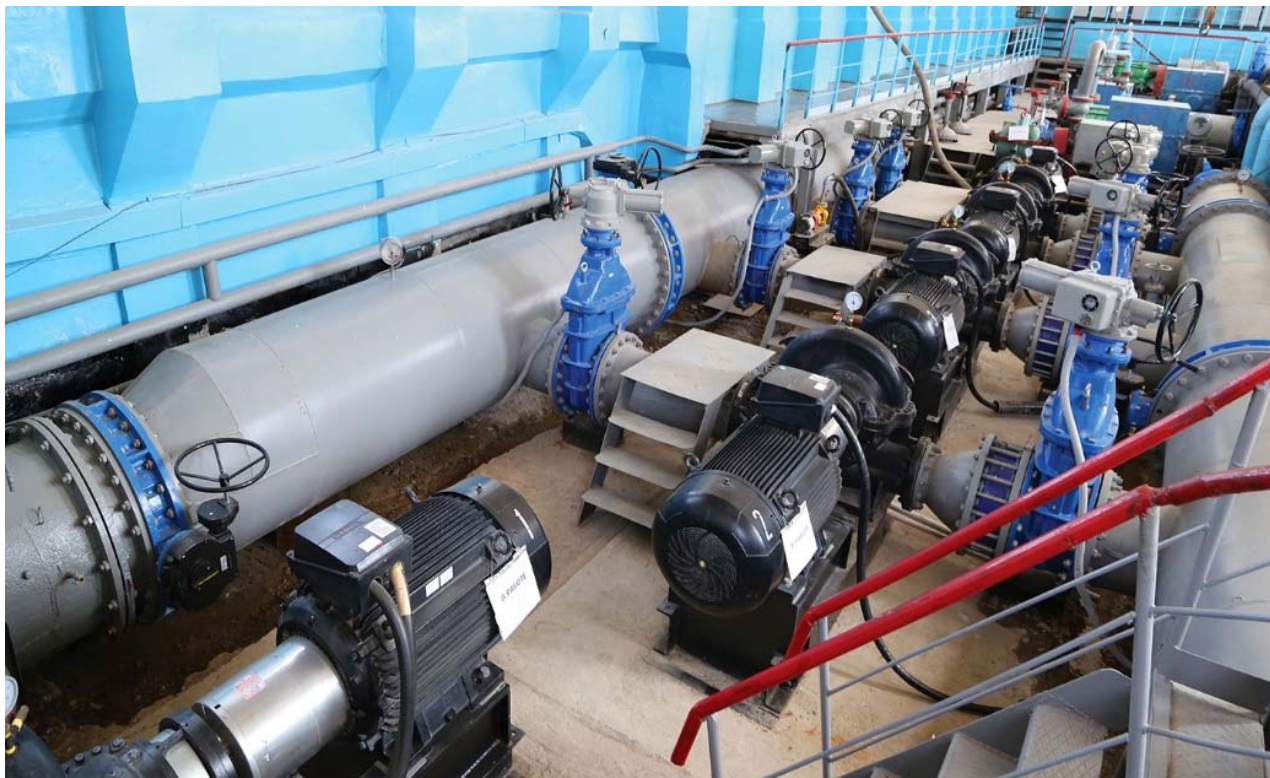
Фото: Насосы Grundfos HS, 200 кВт, на станции второго подъема ВОС
