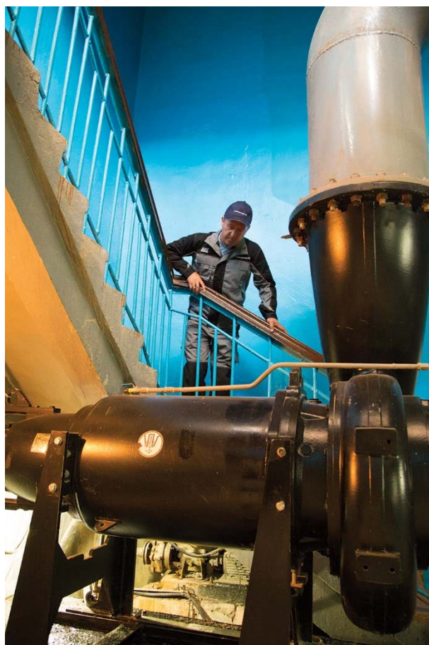
Фото: Специалист КГП «Атырау Су Арнасы» осматривает насос S3, 160 кВт, установленный на станции первого подъема
