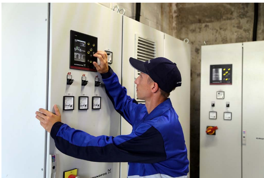
Фото: Дежурный оператор КГП «Атырау Су Арнасы» задаёт параметры работы насосных агрегатов в шкафу управления Control MPC на фильтровальной станции №4
