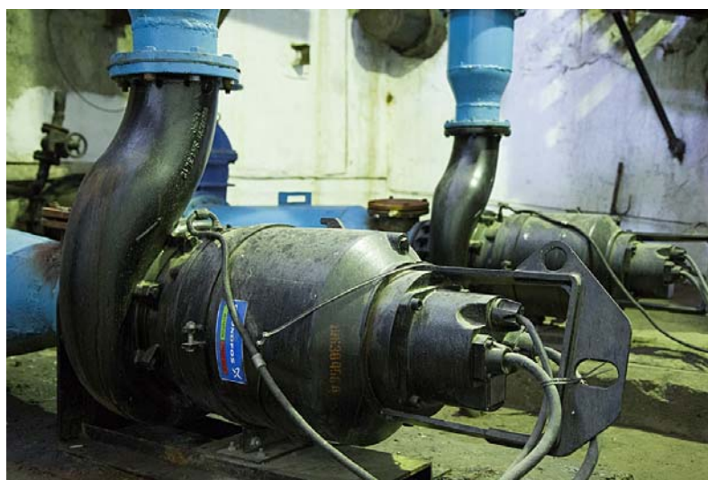
Фото: Канализационные насосы S2 – 43 кВт, установленные в КНС-18
