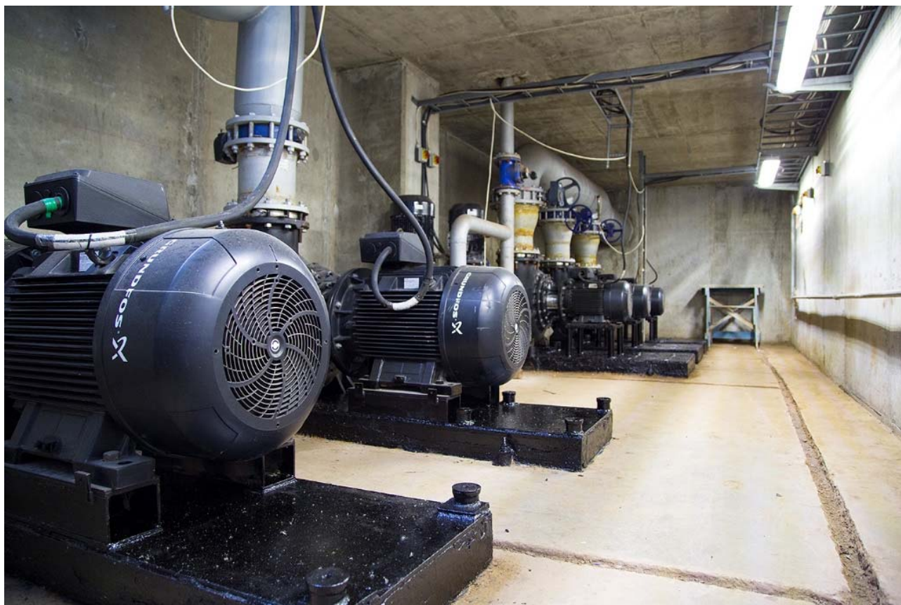
Фото: Консольные насосы NB, 75 и 18,5 кВт, установленные на фильтровальной станции №4
